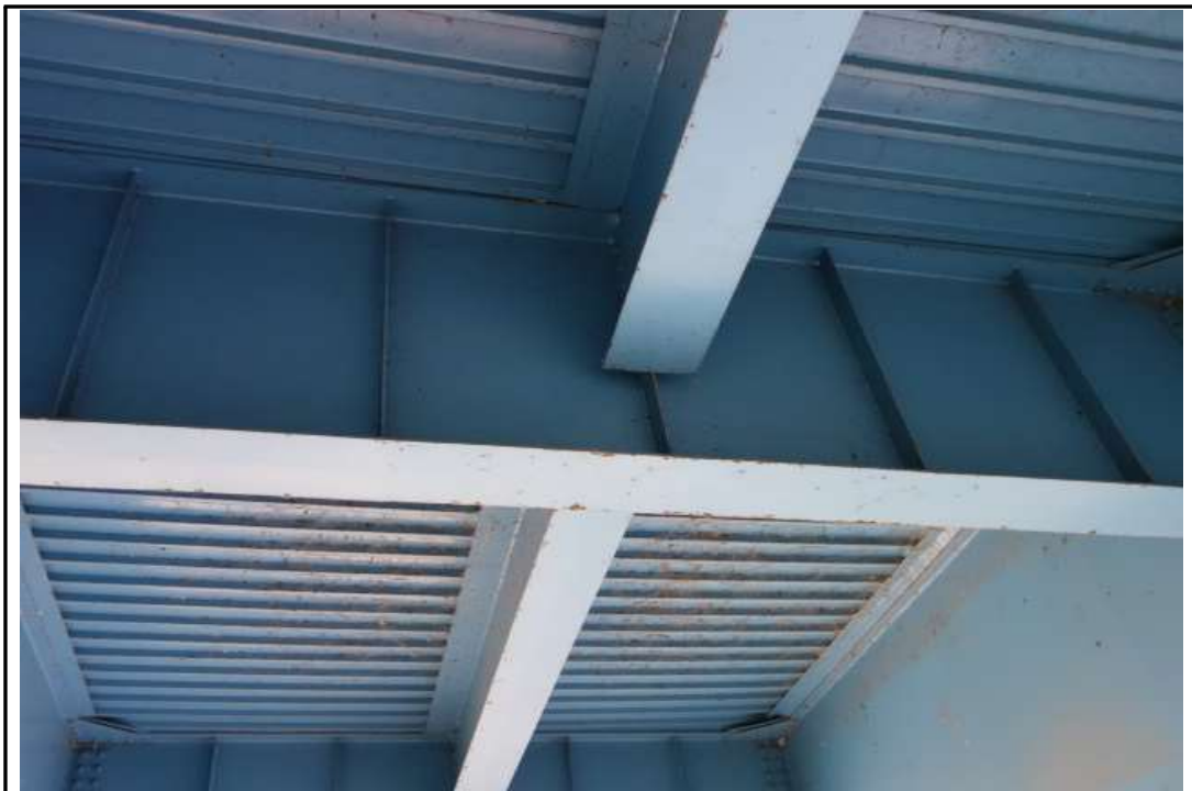
STB 거더 구간 세로보 전경
